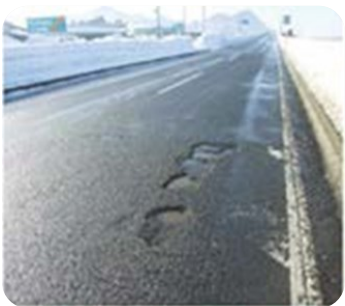
路面の穴ぼこ・ 段差
