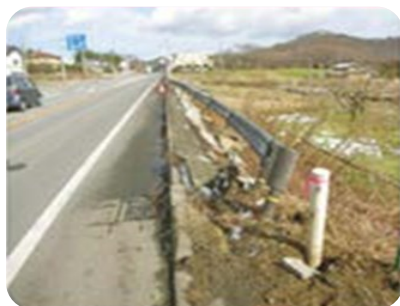
ガードレール・ 標識等の損傷
